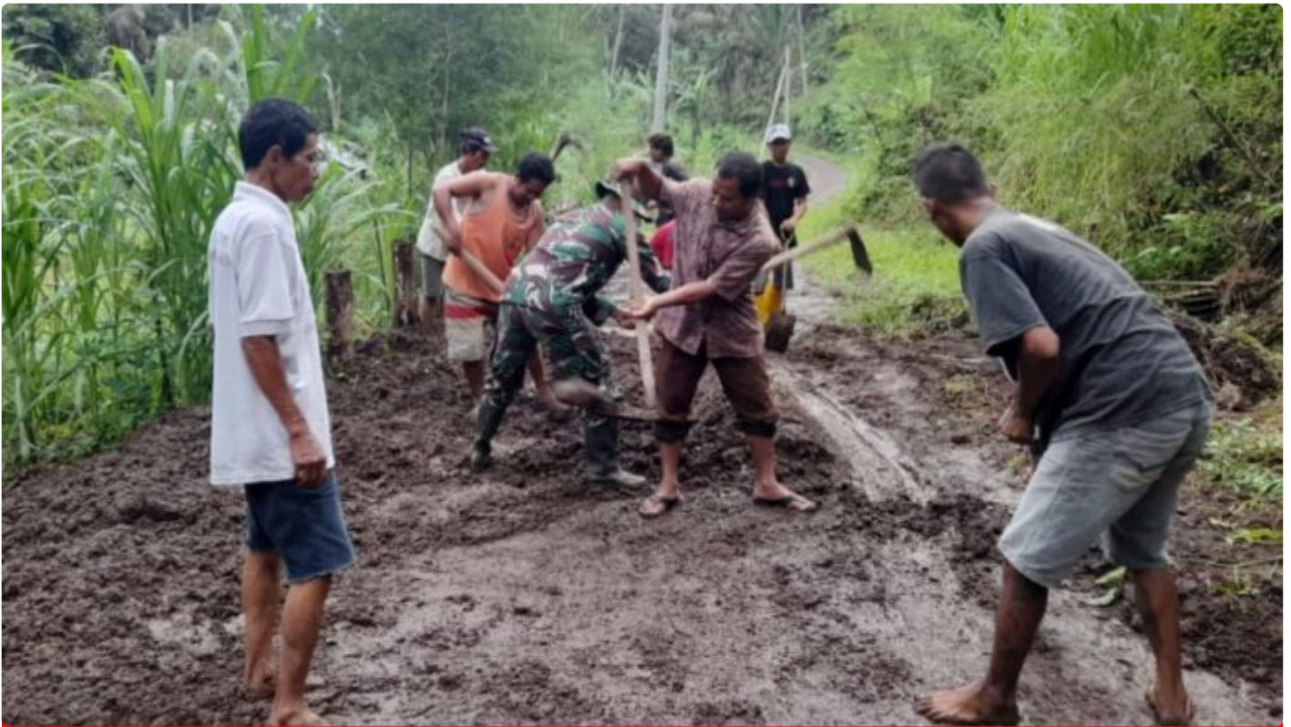
Babinsa Koramil 1609-06 /Banjar gotong - royong bersihkan longsoran tanah yang menutupi jalan
